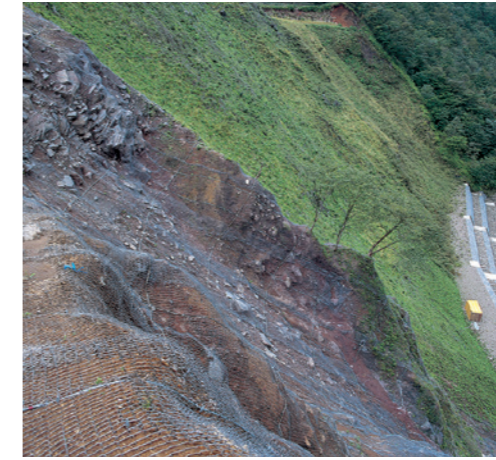
ด้านหน้า : หลังเพิ่งติดตั้ง ด้านหลัง : 1 ปีต่อมา หรือนานกว่านั้น
