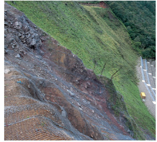
Bagian depan: Segera setelah pekerjaan konstruksi Bagian dalam: Telah lewat 1 tahun atau lebih
