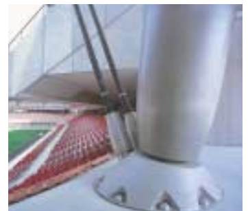
ケーブル端部
