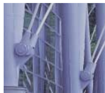
ケーブル端部
