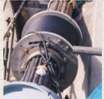
太径ケーブルの測定例
