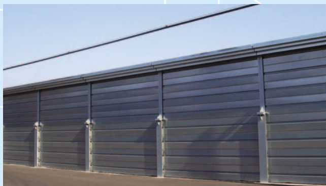
設置例(民地側より) ▶ 構造がシンプルで美観を損ないません。
