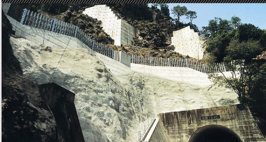
FMF-DC20NC300-0.5型(端末部:コンクリート製) トンネル坑口付近に設置
